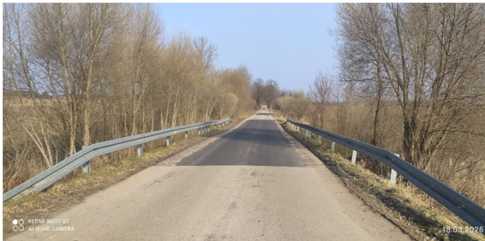
Fot. Powiatowy Zarząd Dróg w Pisz Remont nawierzchni bitumicznych dróg powiatowych Nr 1865N oraz 1720N
